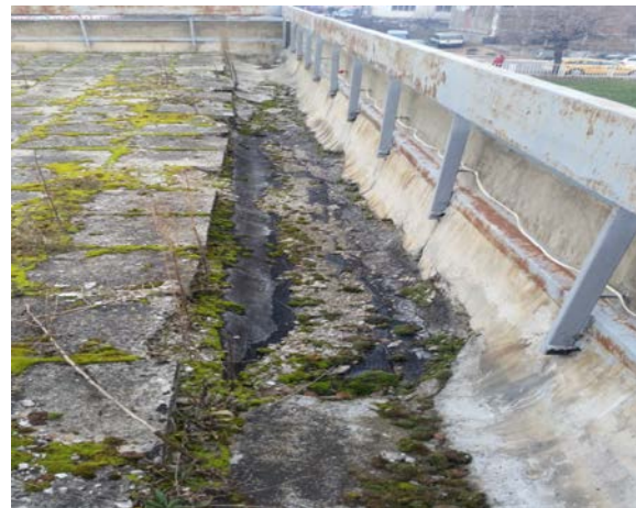
*Detalj oštećenog sloja za pad u oluku
